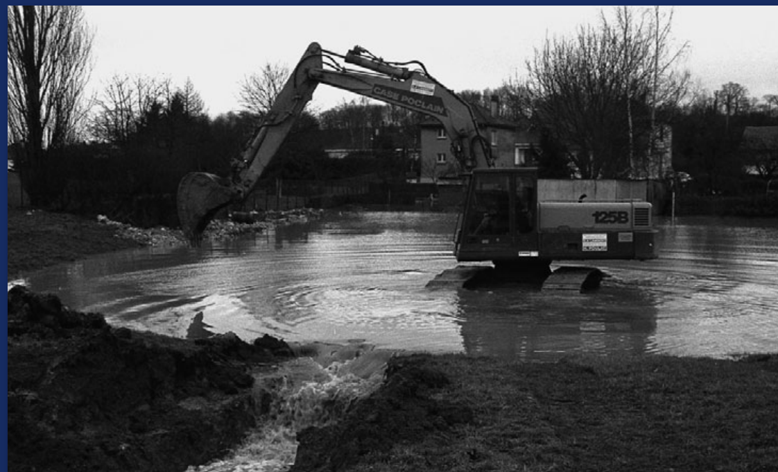
La Serre, évacuation des eaux d'inondation dans la zone artisanale de Marle (02) (photo Service de la Navigation de la Seine, 23/12/1993)
